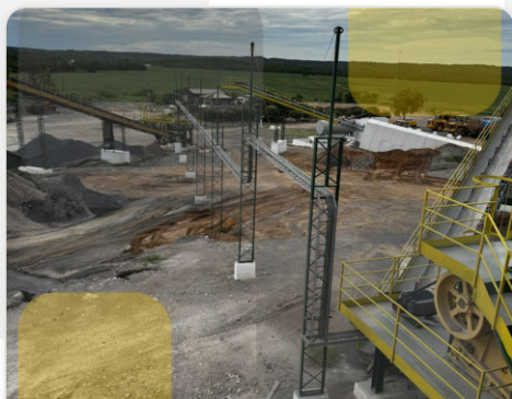
Postes e eletrocalhas na britagem
