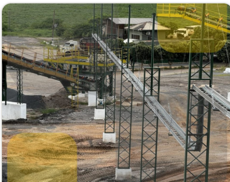
Vista geral do pipe-rack de cabos
