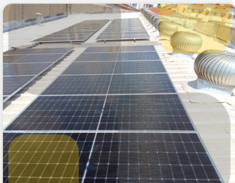
Módulos fotovoltaicos na cobertura
