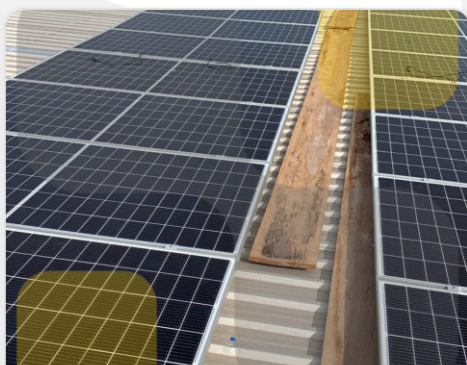
Módulos fotovoltaicos na cobertura
