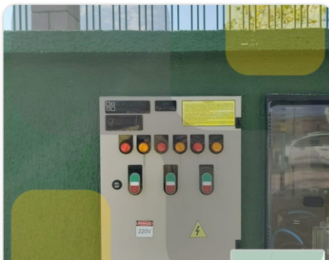
Quadro da casa de máquinas
