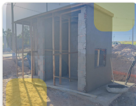
Abrigo do quadro elétrico em alvenaria
