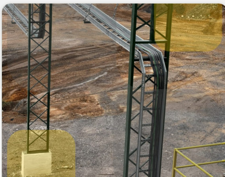
Eletrocalha e torre de sustentação
