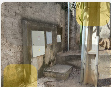
Quadros de medição e proteção
