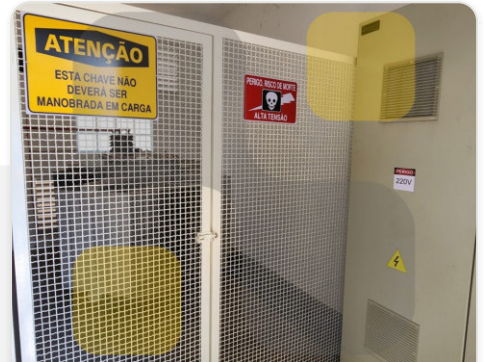
Grade de proteção e sinalização
