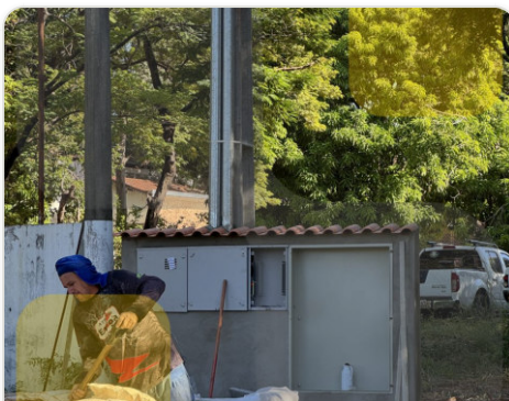
Caixa de medição e eletrodutos
