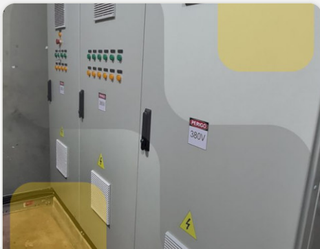
Sala de painéis (CCM)
