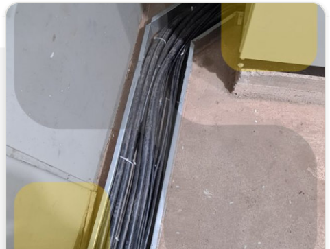
Cabeamento em canaleta
