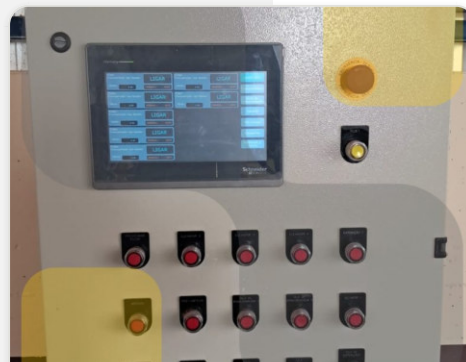
Painel de operação de campo
